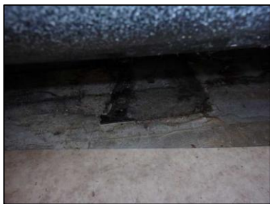
Photo N° 3 ECH-N°001 -1ER Droite-Salle de Bains Sol sous baignoire Matériau souple bitumineux
