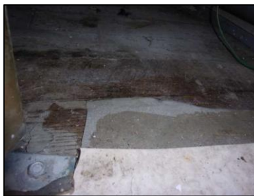
Photo N° 4 ECH-N°002 -1ER Droite-Salle de Bains Sol sous baignoire Colle jaune
