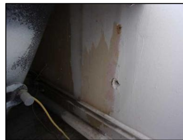
Photo N° 5 ECH-N°003 -1ER Droite-Salle de Bains Murs Peinture / plâtre
